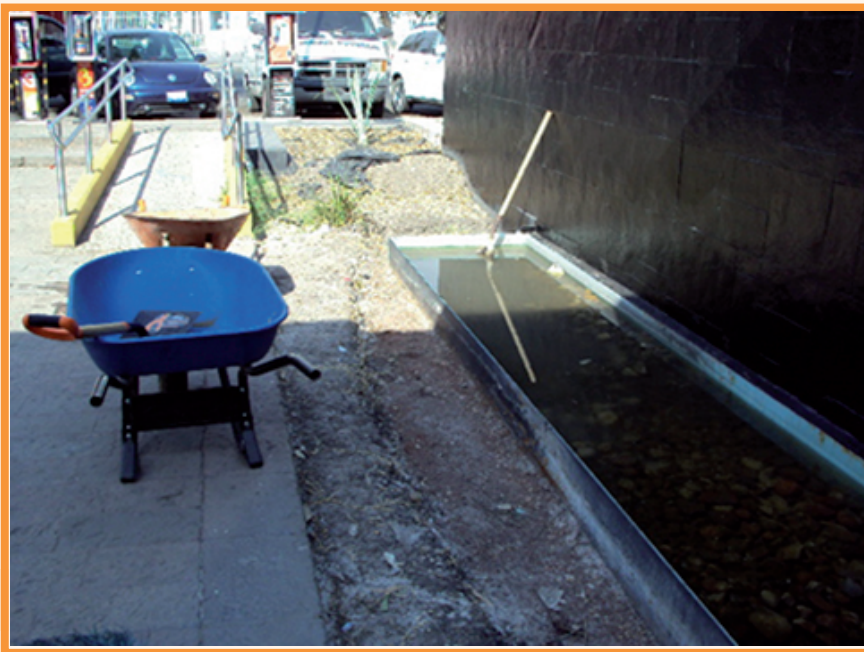
Mantenimiento a la fuente de la entrada principal
