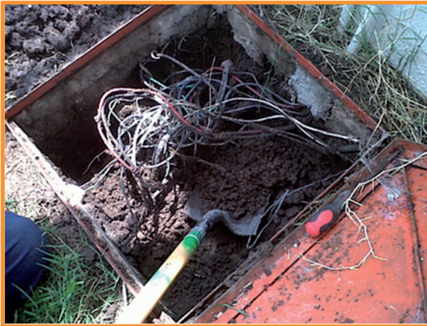
Mantenimiento a los registros eléctricos con problemas de inundación y humedad
