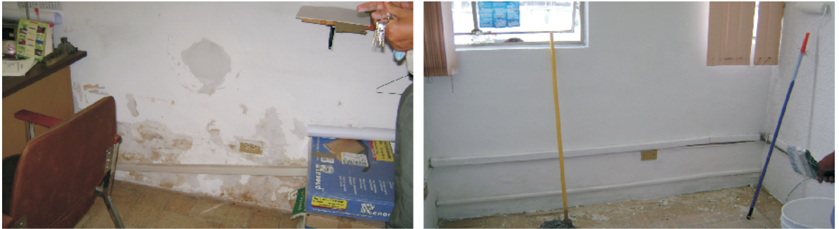
Cubículos de Metal Mecánica en mal estado, en proceso de pintura
