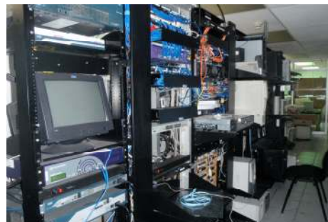
Imagen del SITE de comunicaciones.
